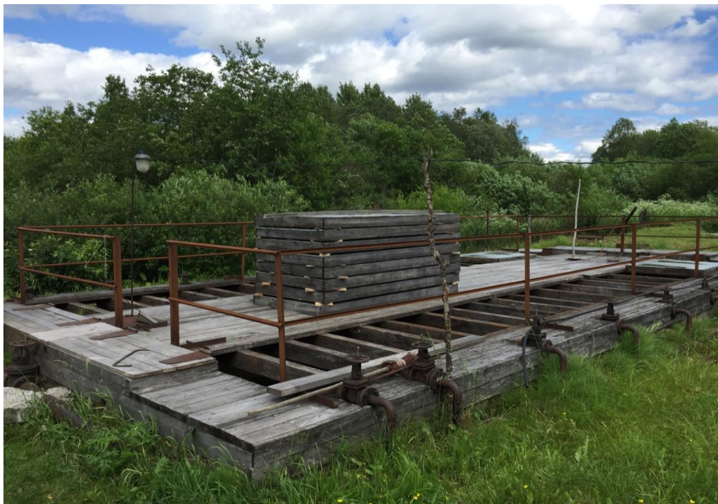
Рисунок 1.1.3. Очистные сооружения пос. Святозеро
